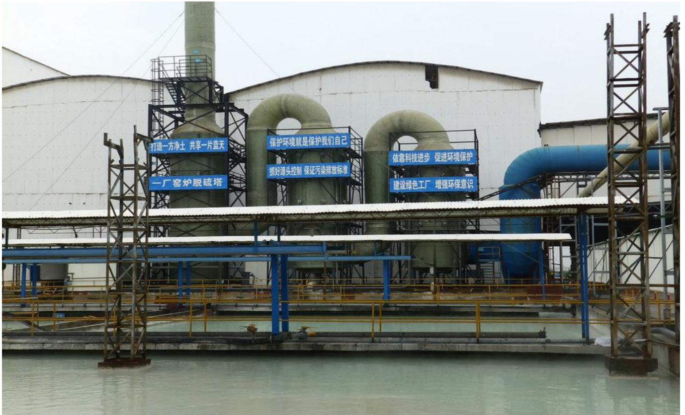
图二、新明珠建材有限公司的脱硫塔。
